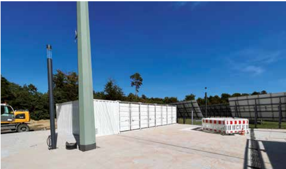
Abb. 14: H 2 -in-the-Loop-Anlage für Wasserstofftechnologie-Experimentelle Prüfung.
